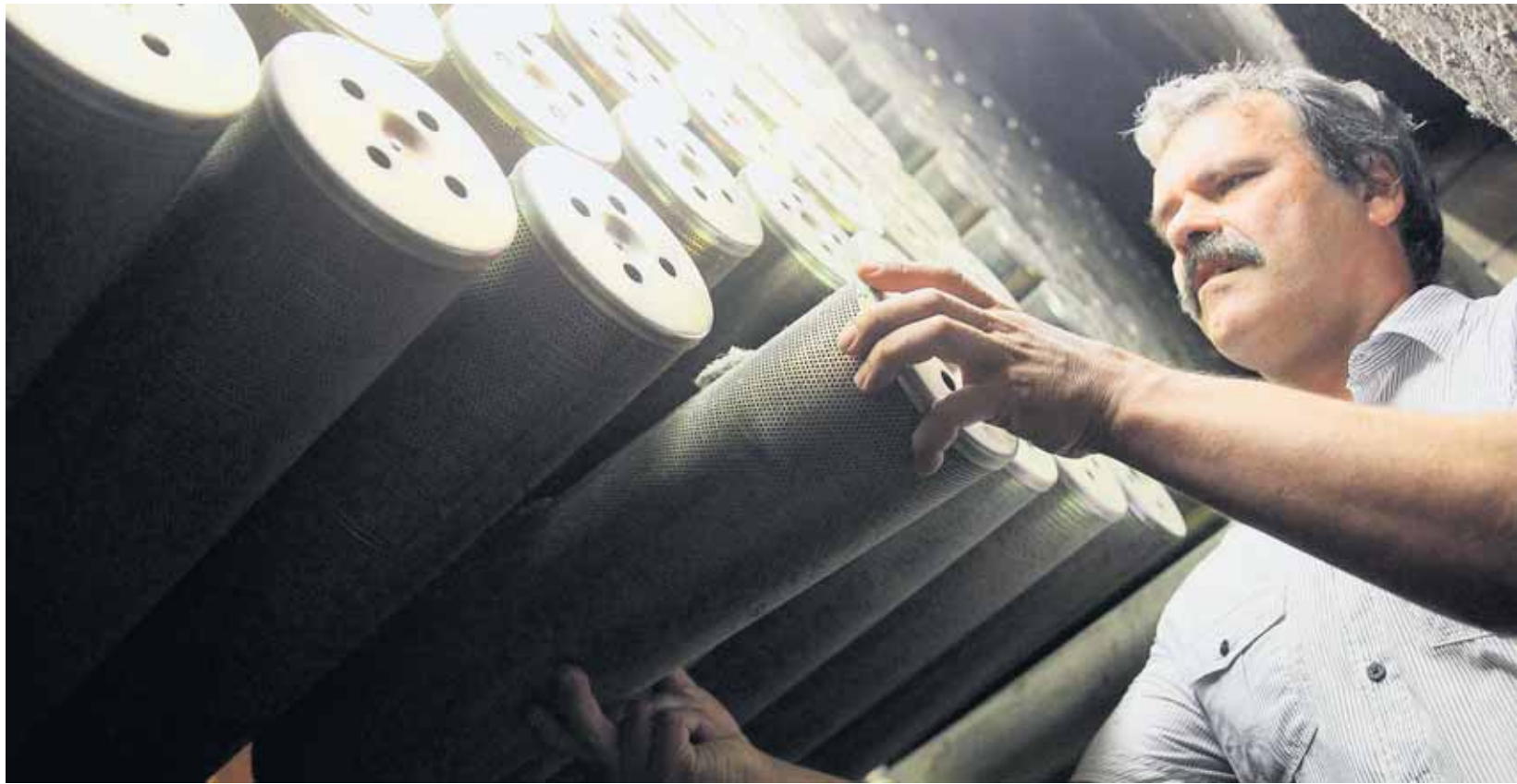
556 Filterpatronen, gefüllt mit Aktivkohle, haben Ingenieur Frank Riedel (Bild) und seine Mitarbeiter in den Abluftkamin des Recyclingbetriebs Eu-Rec installiert.
